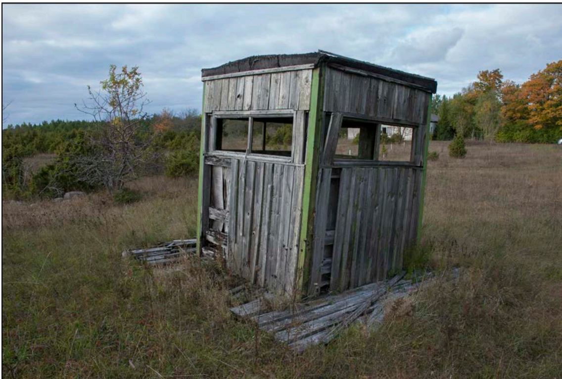
Foto 18. Kõruse kordon. Õppeväljakul [13] olnud metallist vaatetorn on lammutatud, alles on torni vundament ja tervelt maha tõstetud ülemine platvorm koos putkaga. Taga paistab kaardile kandmata tellistest hoone.
